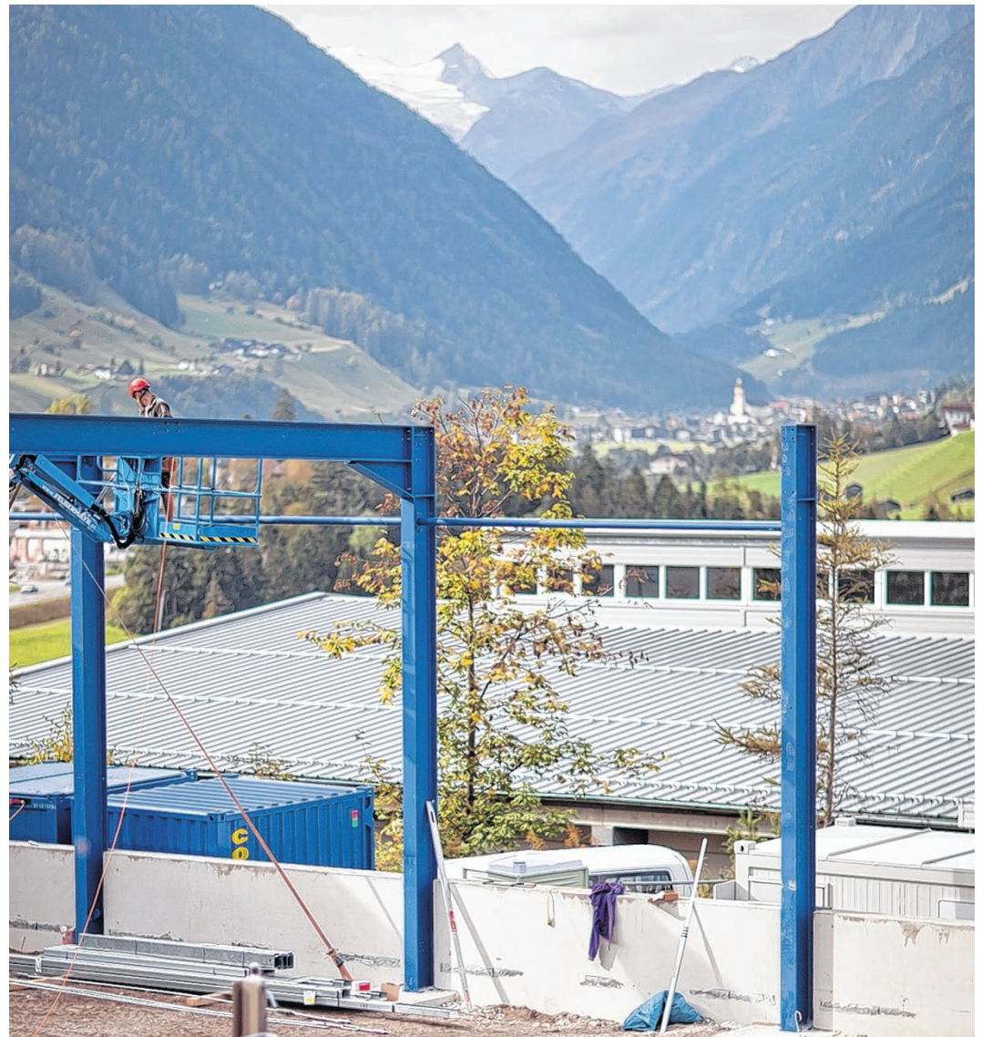
Auf einer Fläche von 1.200 Quadratmeter entsteht bis 2015 eine neue Werkshalle mit hochpräzisen Geräten und einer topmodernen Klimaanlage.
